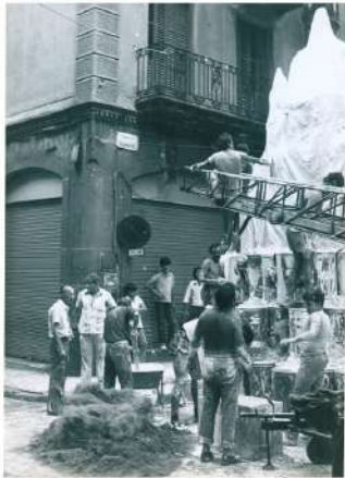
Festers del carrer Puigmarí construïnt una de les portalades amb una estructura de bidons usats recoberts d'estopa enquistada. Festa Major de Gràcia 1981. Autor desconegut. Fons: Anxelu JMC.
